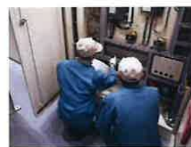
設備日常点検
